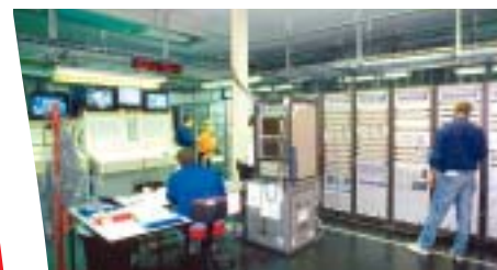
Procesos industriales: autómatas programables, procesadores de variadores de velocidad...
