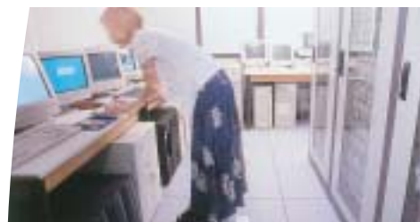
Servidores y unidades de almacenamiento de datos, equipamiento de networking...
