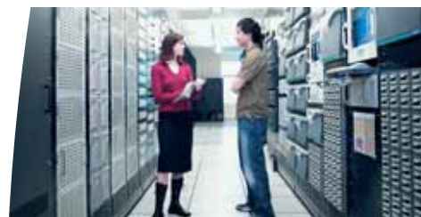
Centros de datos: servidores de aplicaciones, de comunicación, bases de almacenamiento de datos, elementos activos de red.
