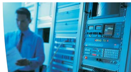
Integración en los racks de alta densidad.
