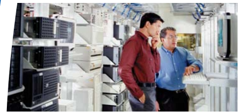
Integración en los racks de alta densidad.
